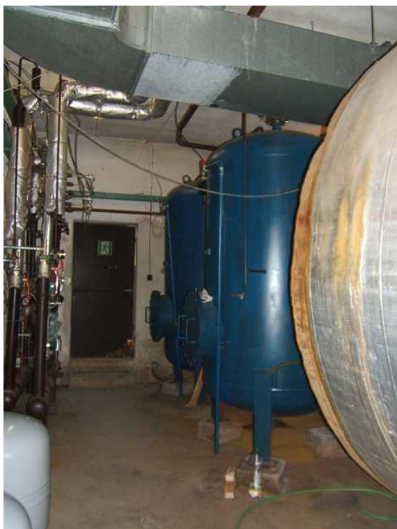
Vybavení elektrokotelny umístěné pod terasou
